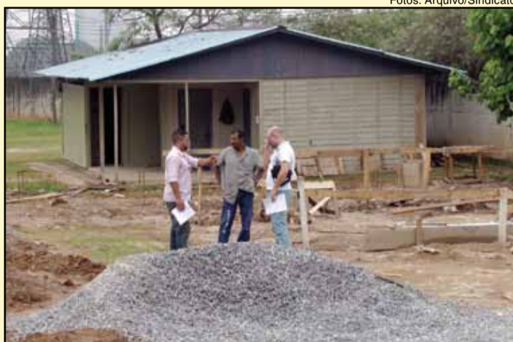
Diretores do Sindicato visitam as obras da Área de Lazer da Linha 5
