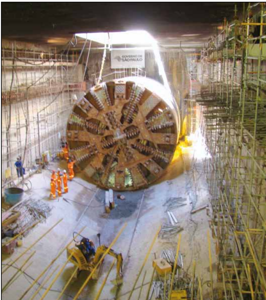
Expansão e obras do Metrô no governo tucano já vitimaram nove pessoas e provocaram a interdição de diversas casas
