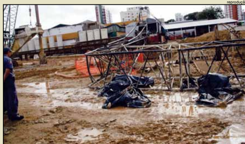
Guindaste cai e mata dois operários em obra do Metrô
