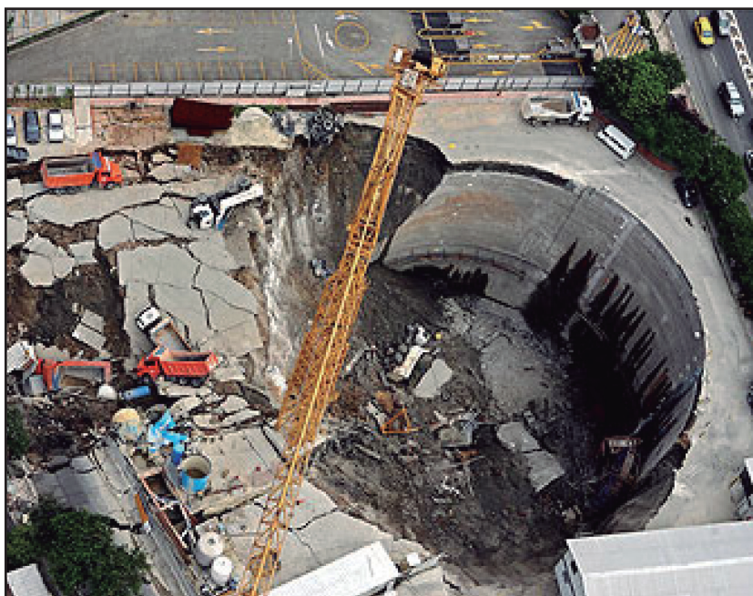
Cratera na obra da estação Pinheiros deixou sete pessoas mortas em 2007
