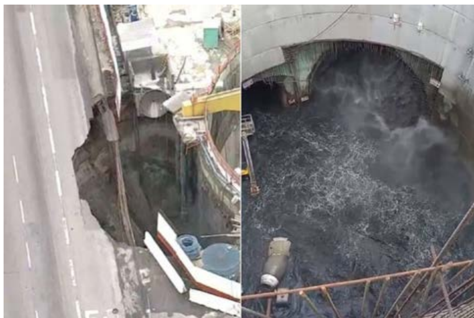
Cratera aberta após incidente nas obras da Linha 6 - Laranja
